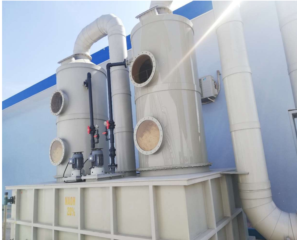
Hình 2-8 Máy trung hòa clo
